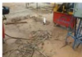
电缆线随意拉设 (✗)
