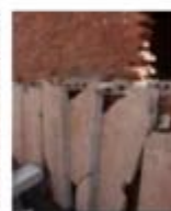
预制板质量不 合格，断裂(✗)
