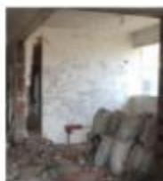
建筑垃圾、废渣集中 堆在楼板上（×）
