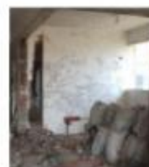
建筑垃圾、废渣集中 堆在楼板上 (✗)
