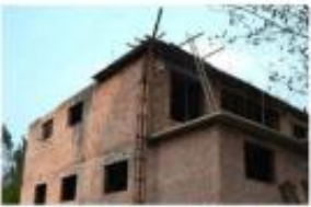
未设置圈梁、构造柱 (✗)
