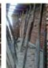
立杆接长未采用对接夹板接头(✗)
