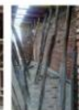
立杆接长未采用对接夹板接头(✗)
