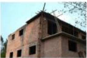
未设置圈梁、构造柱 (✗)
