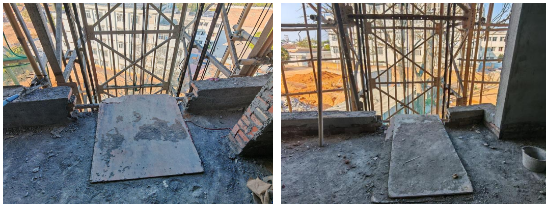
图 6 升降机层站入口情况
