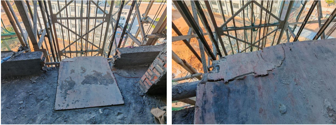
图 9 升降机八楼层站口脚手板及开裂情况
