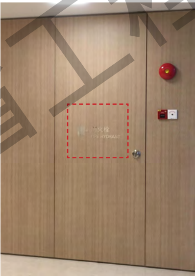
消防栓暗门标识
