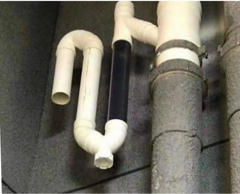
首层防堵塞溢流装置
