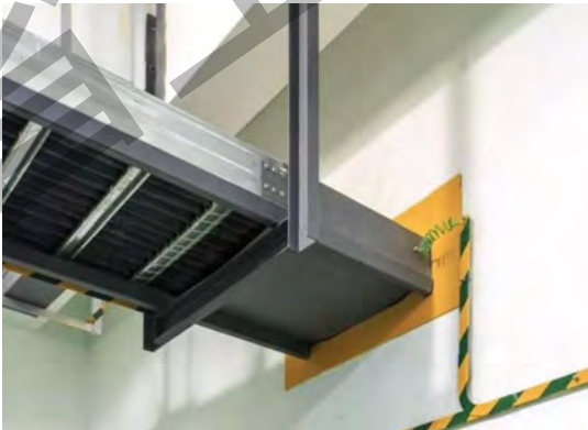
电缆桥架穿防火墙
