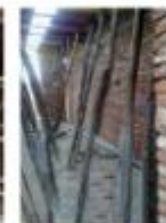
立杆接长未采用对接夹板接头(✗)
