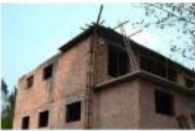
未设置圈梁、构造柱 (✗)
