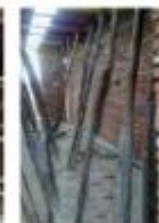
立杆接长未采用对接夹板接头(✗)
