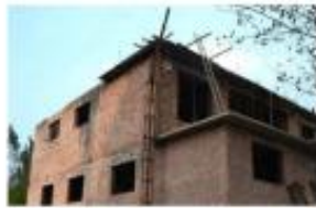
未设置圈梁、构造柱 (✗)
